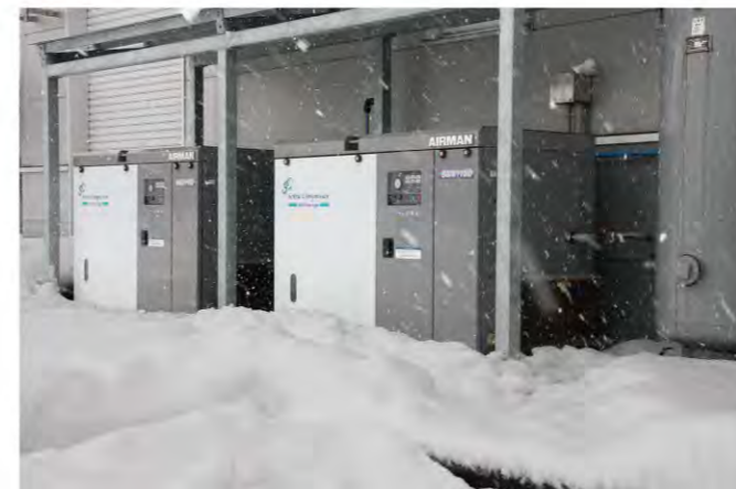
製造工場 SMS15SD(旧型機)×2台
